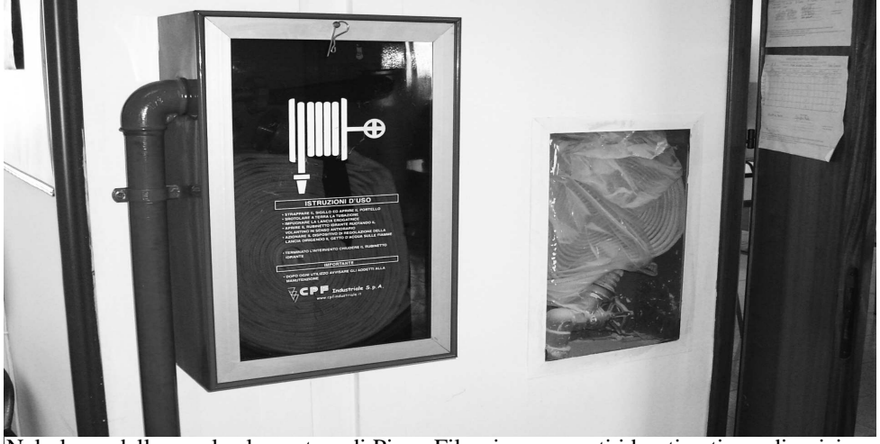
Nel plesso della scuola elementare di Piano Fileccia sono sorti idranti antincendio vicino ad altri già installati e perfettamente funzionanti. Miracoli salemitani
