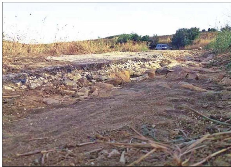
Sopra e a destra due strade provinciali dissestate
