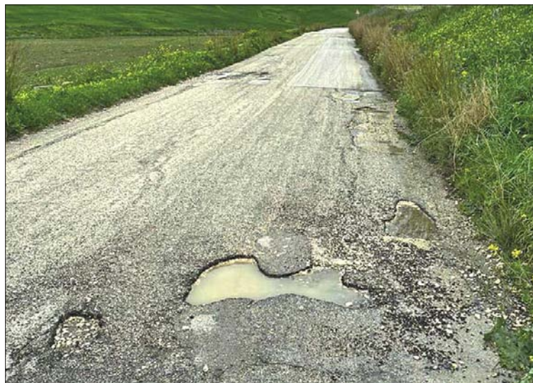
Una delle strade dissestate; a destra il palazzo municipale
